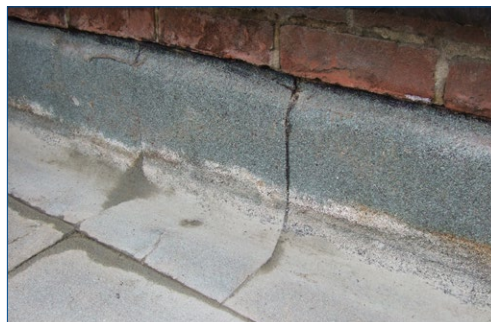
Juntas con filtraciones
