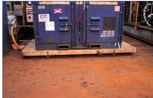
Superficie de la plataforma corroída
