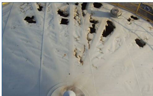
Techo de un tanque agujereado
