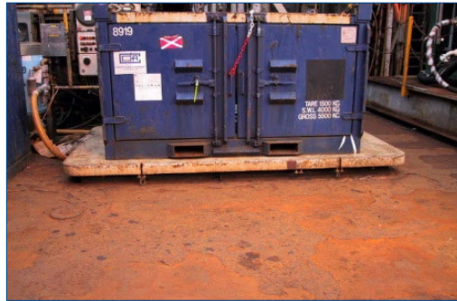
Superficie de la plataforma corroida
