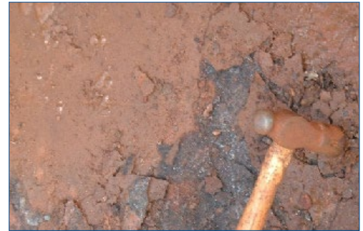
Primer plano de la superficie de la plataforma corroida
