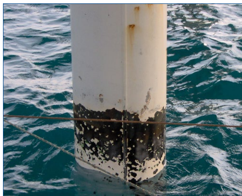
Pata de la plataforma corroída
