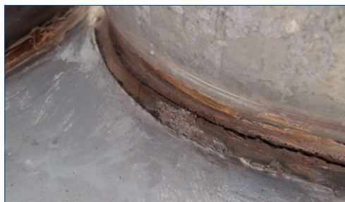
Unión deteriorada en una unidad de climatización
