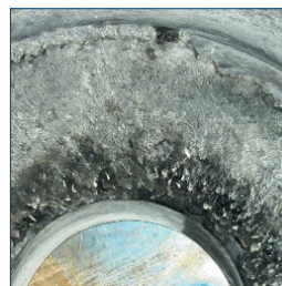
Revestimiento de caucho dañado en la carcasa de una bomba
