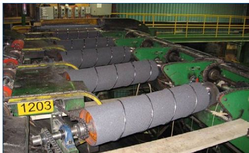
Sistema antideslizante aplicado a los rodillos de transferencia en el aserradero
