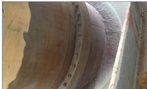
Brida de 52" tratada con granallado abrasivo
