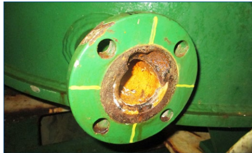
Cara de brida muy corroída
