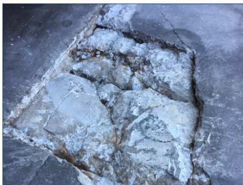
El impacto del tránsito intenso puede dañar el hormigón
