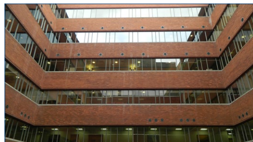
Bloque de oficinas que necesitaba reparaciones de mampostería
