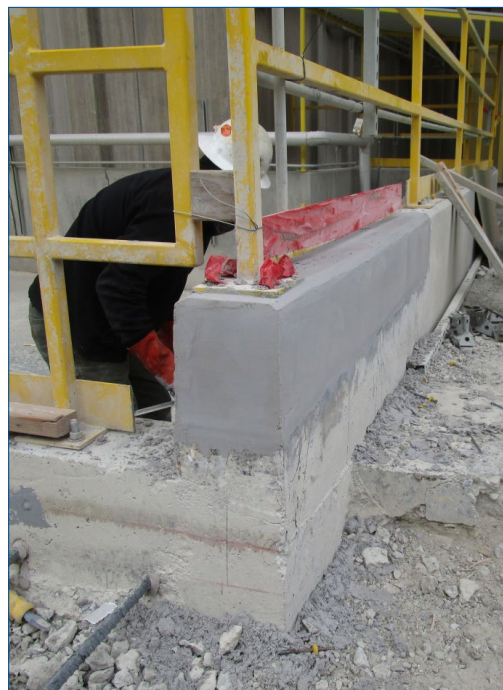
Pared de contención secundaria reconstruida y terminada con una capa de Belzona 4111
