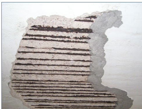
El metal corroído produce desprendimientos de hormigón
