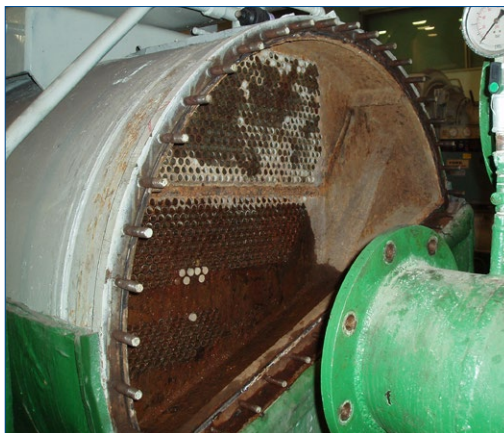
Placa de tubos antes de la aplicación
