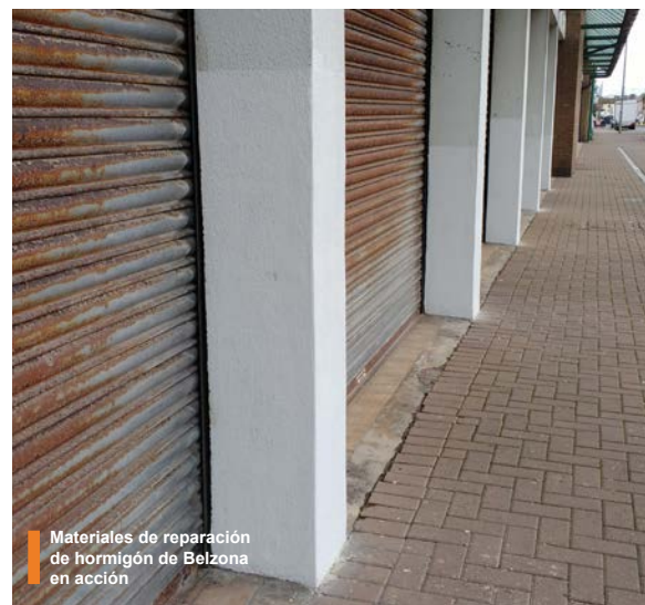
Una serie de pilares de hormigón necesitaban reparación
