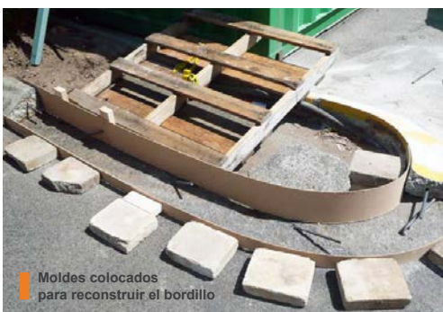
Bordillo dañado y desprendido
