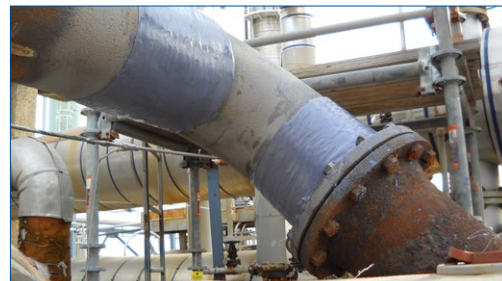
Defecto de pared delgada reparado
