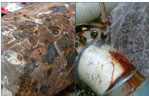
Fig. 1: Daño por erosión, corrosión y picaduras. Daño con perforación de pared que resultó en fugas
