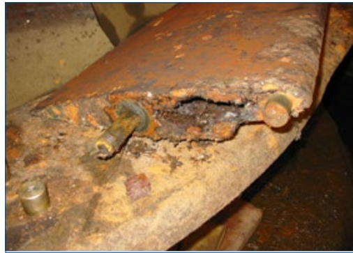
Álabe directriz dañado
