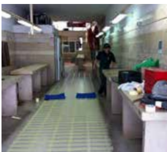
Piso de baldosas antes de la aplicación
