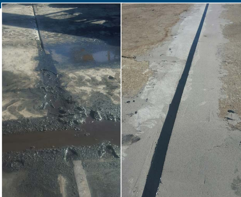
El antes y después de la junta de dilatación en los muelles de Alabama - Terminal de carbón McDuffie
