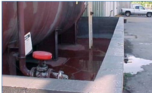
Daño al hormigón debido a la falla del sistema
