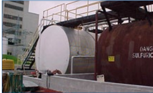
Áreas de contención de ácido sulfúrico (derecha) y de cáusticos (izquierda)
