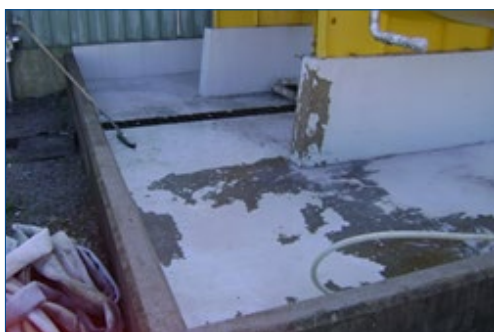
Depósito de contención de ácido sulfúrico al 98% que debe ser reparado
