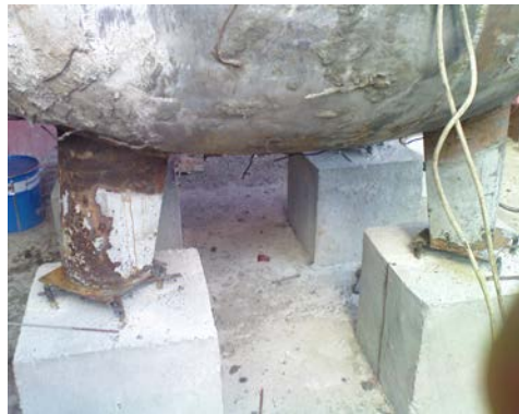
Deterioro del soporte del recipiente
